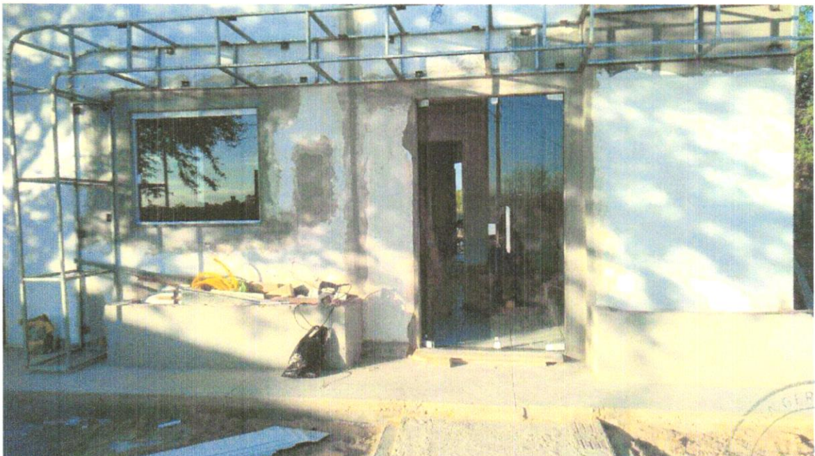
FOTO 14 -revestimento metálico em alumínio composto (Alucobond), e=0,3mm, pintura Kaynar 500 composta por seis camadas, inclusive estrutura metálica auxiliar em perfil de viga "U" de 2" - fornecimento e montagem
